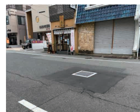
東区の道路。改修前の様子 歪みや割れも多い状況。
